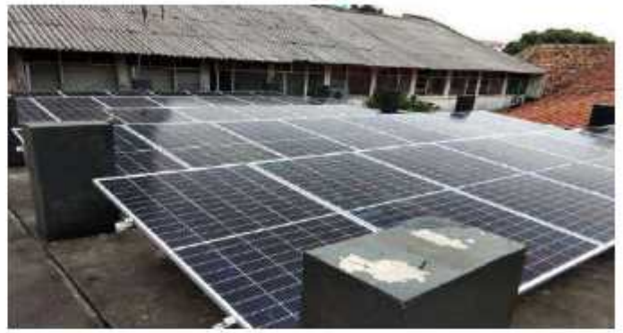
PLTS Gedung Anatomi (15,17 KWp)
