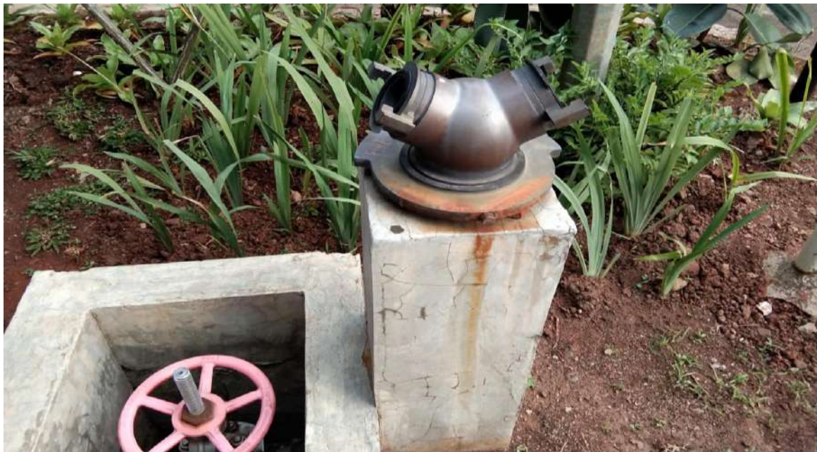
Siamese connection (Koneksi ke mobil pemadam kebakaran)
