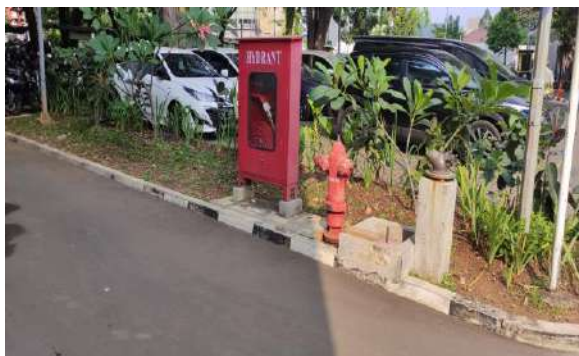
Box Hydrant di luar gedung
