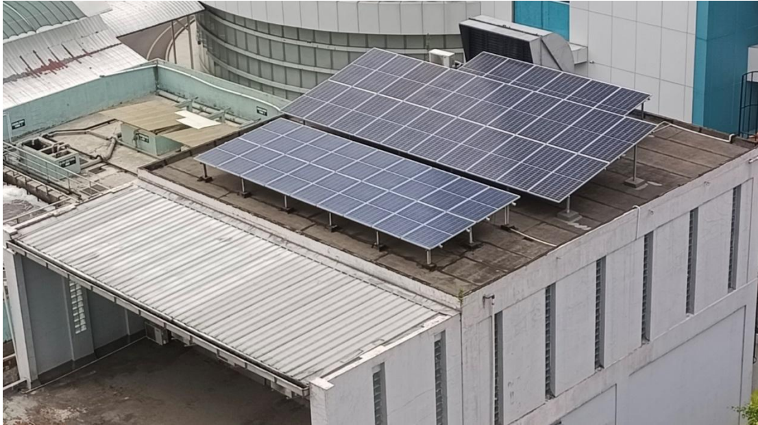
PLTS di atas Dak Gedung Utilitas sebesar 15,17 kWp
