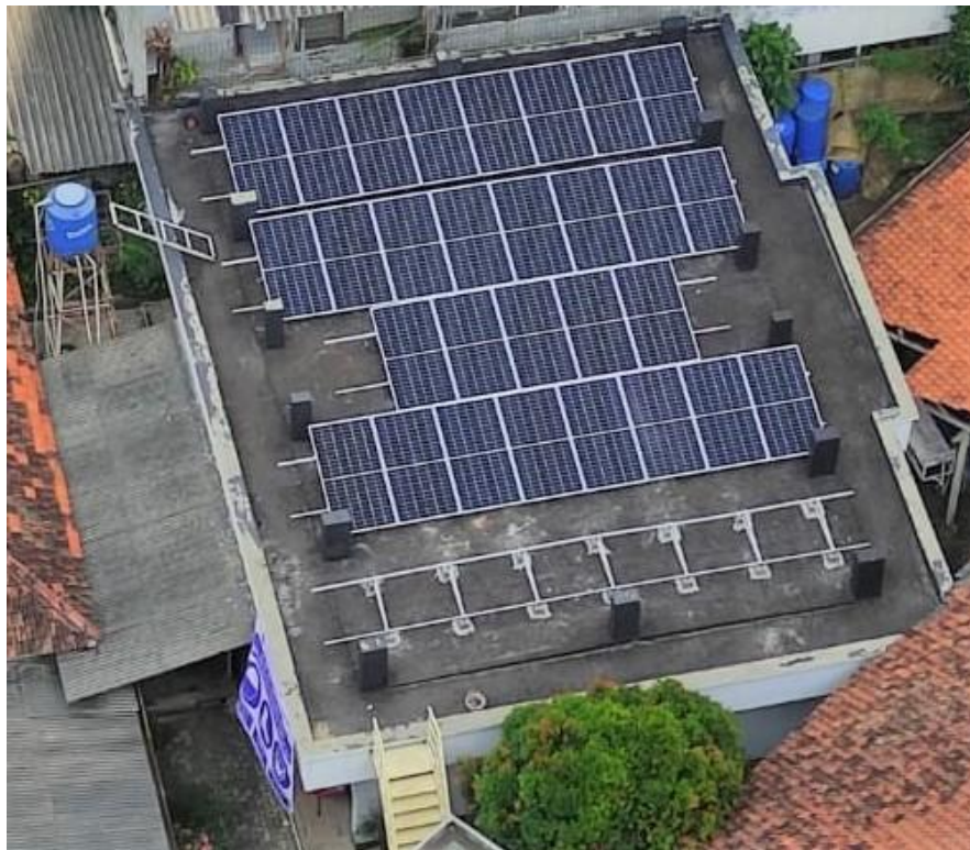
PLTS di atas Dak Gedung Anatomi sebesar 15,7 kWp
