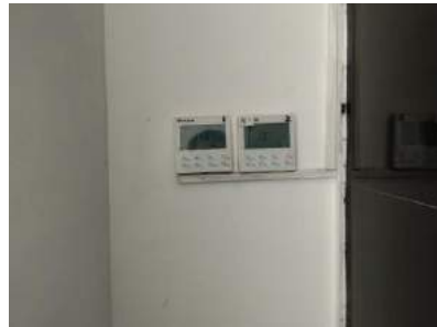
Saklar otomatis chiller Gedung H
