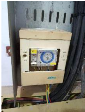
Timer otomatis exhaust fan basement Gedung IMERI
