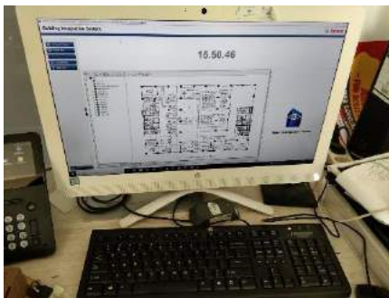
Sistem Building Intregation System untuk aces card di Gedung IMERI
