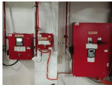
Sistem pemadam kebakaran Gedung IMERI
