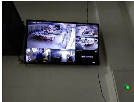
CCTV Lab. Departemen Parasitologi
