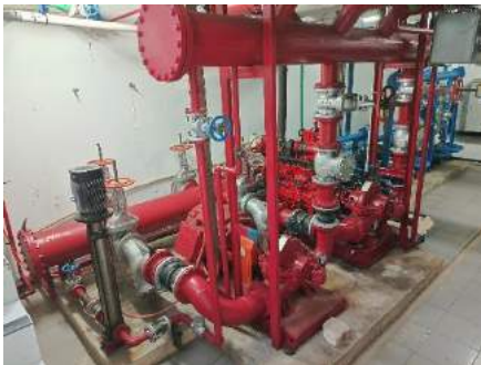
Sistem pemadam kebakaran Gedung IMERI
