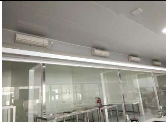
AC split inverter di Lab Parasitologi
