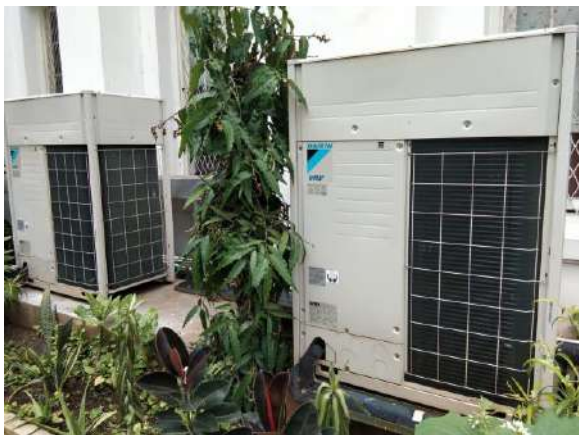
AC VRV untuk menyuplai Laboratorium Departemen Biologi
